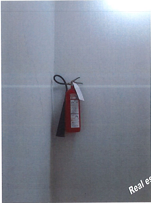
สภาพถังดับเพลิง
