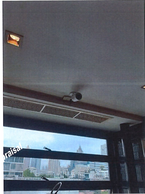
สภาพกล้องวงจรปิด CCTV
