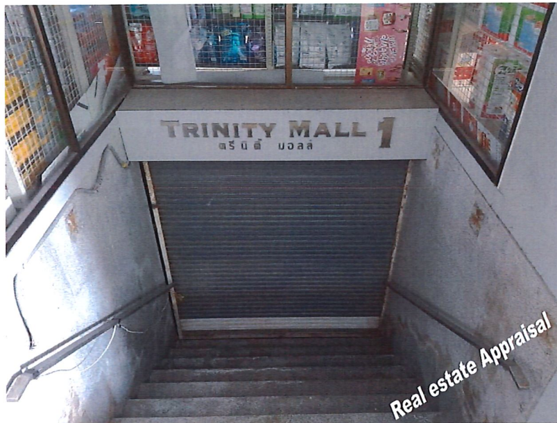
สภาพภายในอาคารชั้นใต้ดิน / ทางเข้าอาคาร (พื้นที่พาณิชย์กรรม) ปัจจุบันปิดดำเนินการ
