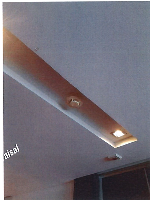
สภาพอุปกรณ์ตรวจจับควัน
