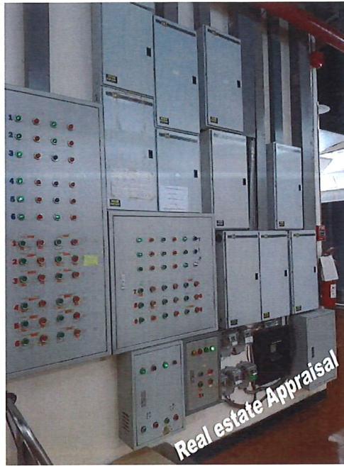
สภาพภายในห้องชุด (พื้นที่พาณิชย์กรรม) / ตู้ควบคุม
